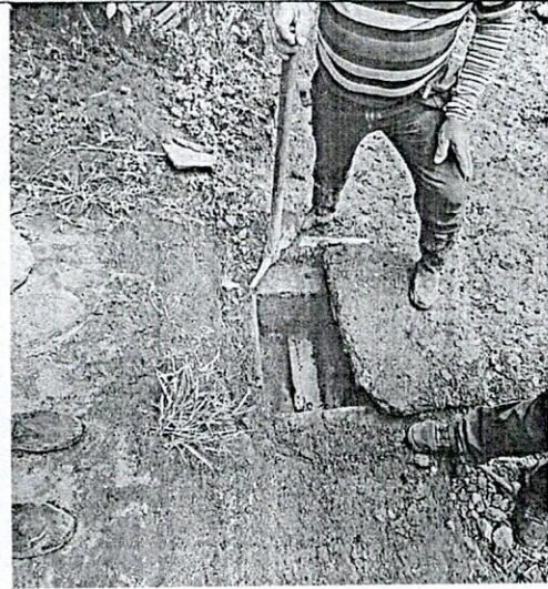
FOTO 12. Detalle caja de inspección para domiciliaria
