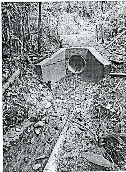
FOTO 5. Detalle descole con entrega final a cauce; aletas en concreto, enrocado y descole filtro
