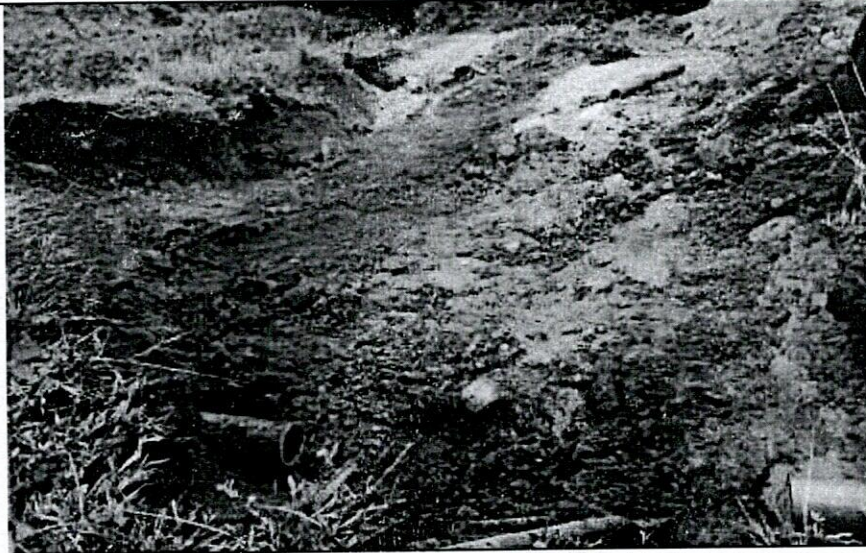
Imágenes 1 y 2. Colapso del tramo de la tubería debido al deslizamiento presentado por las fuertes lluvias
