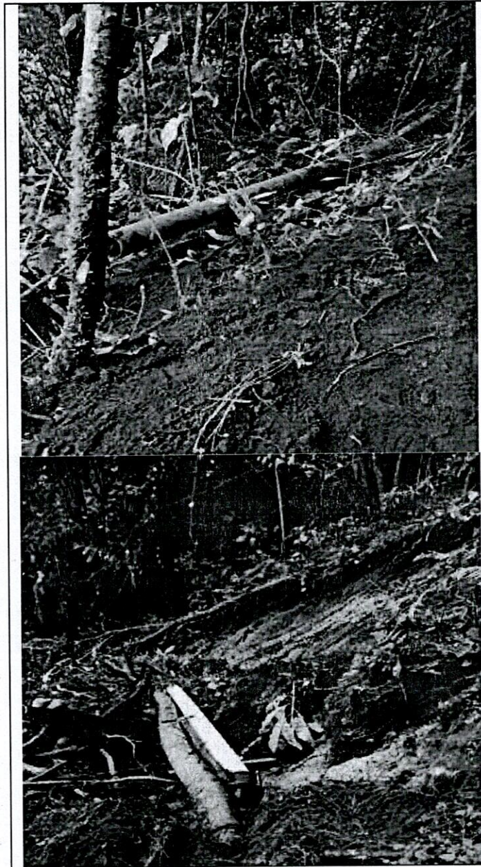
Imágenes 1 y 2. Colapso del tramo de la tubería debido al deslizamiento presentado por las fuertes lluvias
