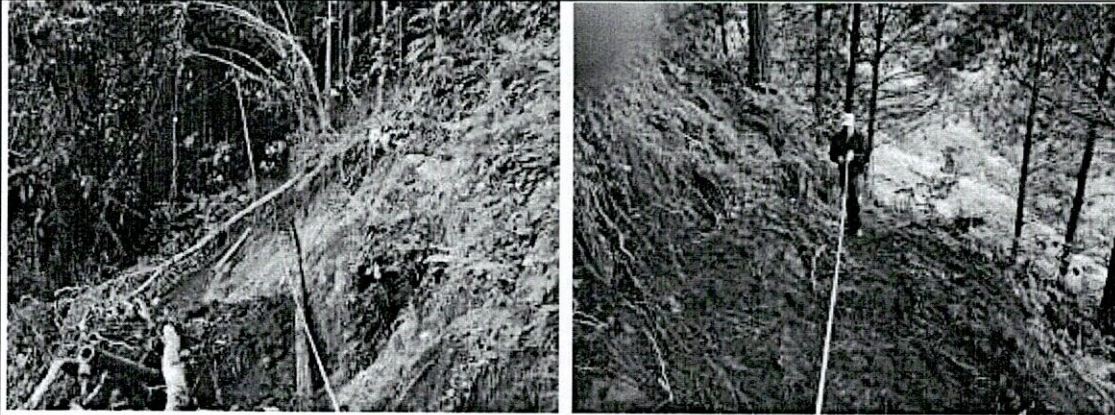
Imágenes 1 y 2. Colapso del tramo de la tubería debido al deslizamiento presentado por las fuertes lluvias ✓
