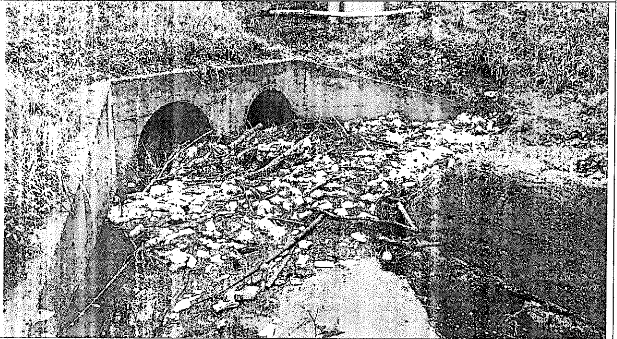
Aguas Arriba Paso Ferrocarril Sector Caño San Javier
