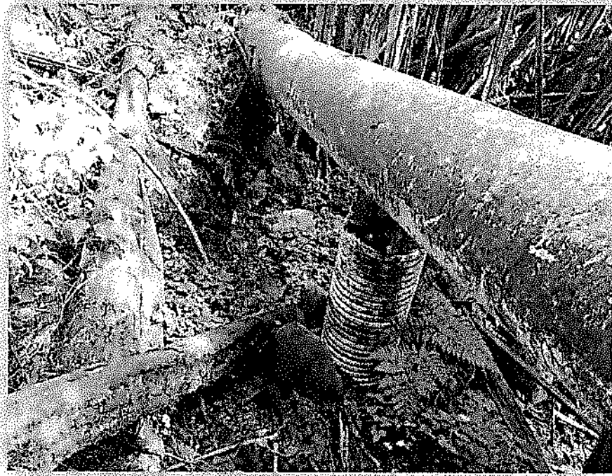
Fotografía 1. .Punto crítico N° 1 Campoalegre – Tubería en talud de alta pendiente sin soporte.
