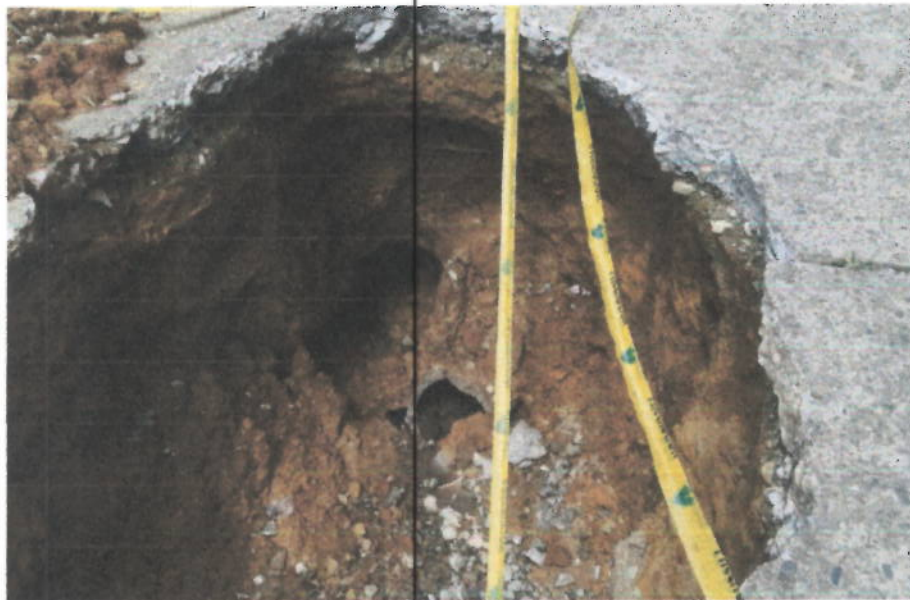
Foto 4. Apique en grieta donde se ve el mal estado de tubería de alcantarillado
