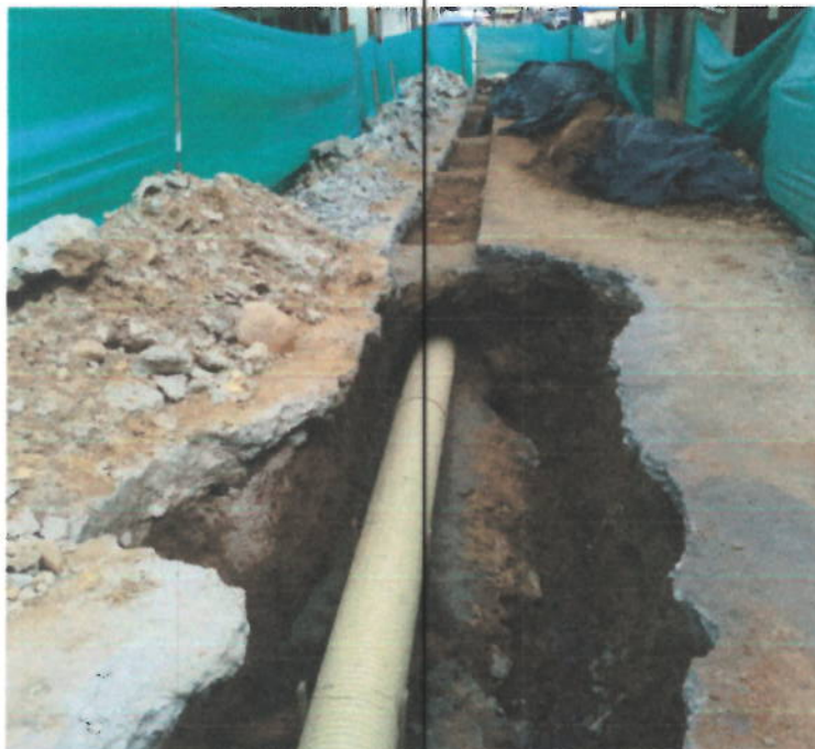
Foto 8. Excavación en zanja con grietas existentes, donde se nota que la tubería antigua pasaba por los lados y generaba hundimientos.
