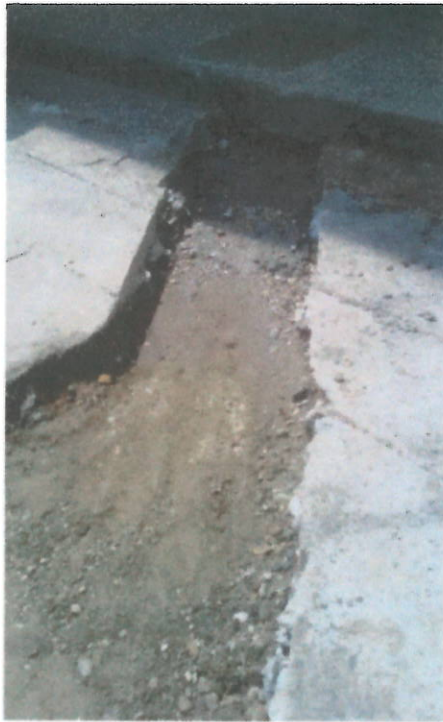
Foto 1. Brecha de domiciliaria de alcantarillado con su respectiva caja
