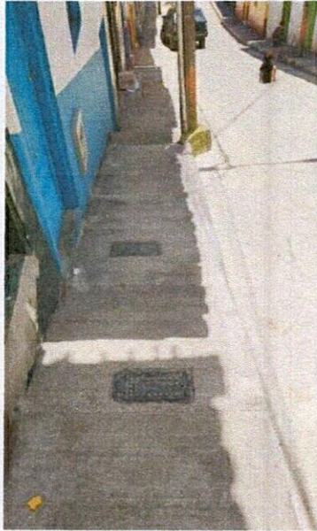
FOTO 17. Cajas metálicas para medidor.
