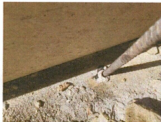
FOTO 12. Acero con epóxido.
