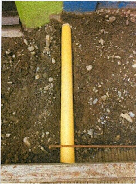
FOTO 7. Tubería para desagüe.
