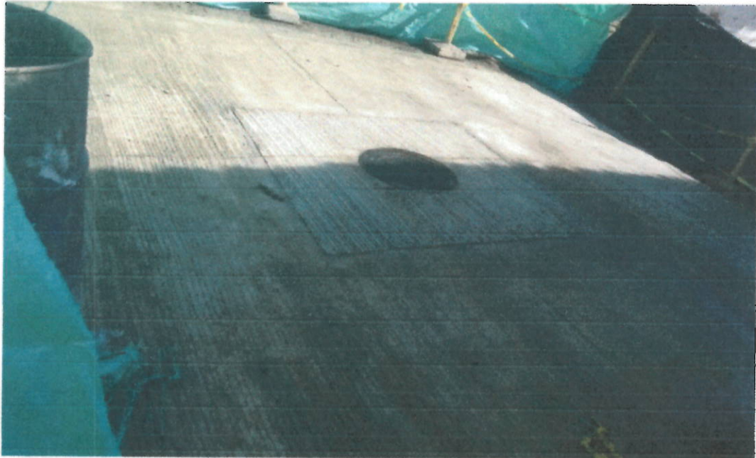
Foto 4. Vaciado de plato en intersección de la carrera 5 con calle 2 e instalación de taparao HF.
