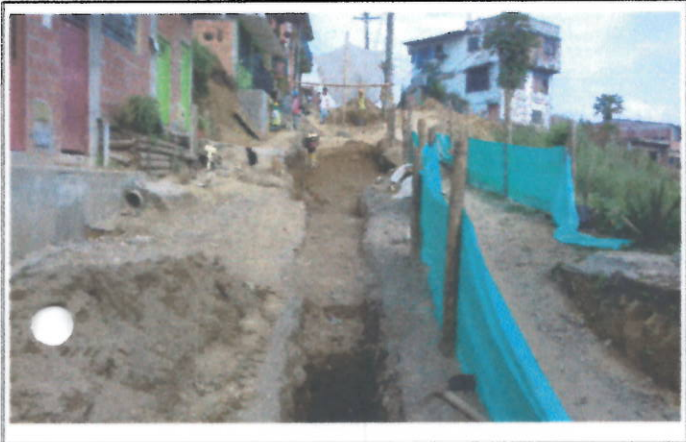
SOBREANCHO EN LA EXCAVACION TERRENO EN LLENO
