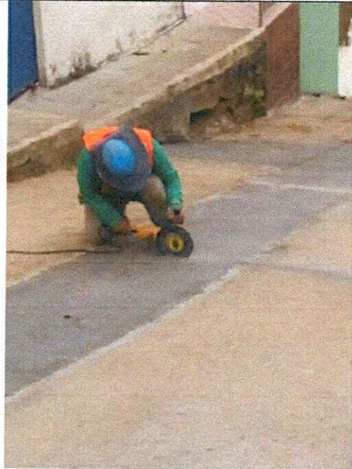
FOTO 12. Cortes del pavimento.
