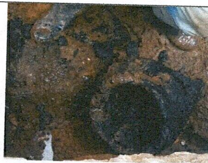
8. Daño encontrado en la tubería.
