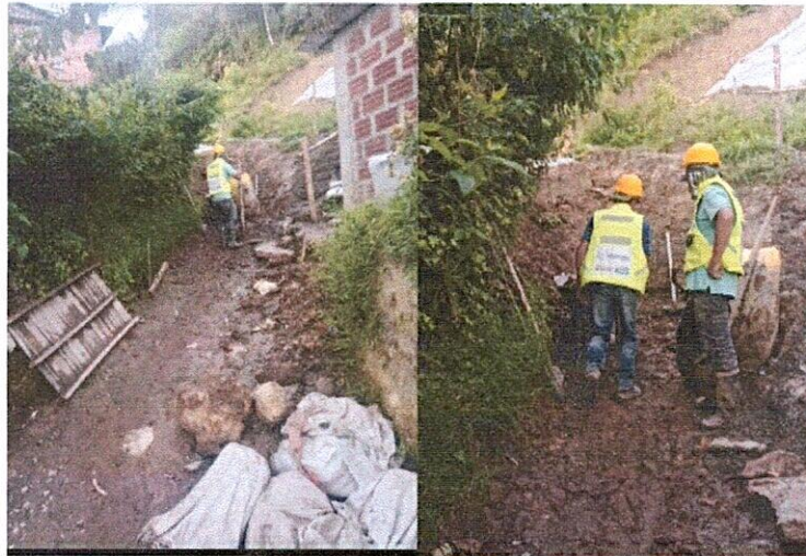
Retiro del derrumbe que obstruyó la vía
