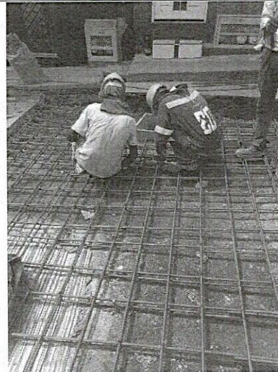
FOTO 8. Proceso instalación de acero de refuerzo para losas de pavimento irregulares y/o con cámara de caída
