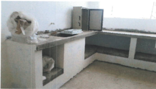
Se construye el contorno de la base con mampostería, en todo el perímetro. Se realiza el estuco y pintura del mismo.
