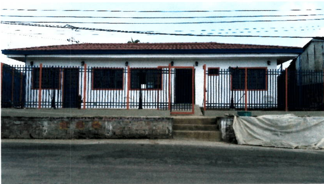
Estado en el que se encuentra la planta después de las intervenciones de las obras hasta el mes de julio.
