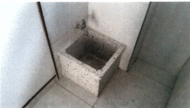
Poceta junto a paredes que están protegidas con cerámica para evitar infiltraciones de agua a muros.
