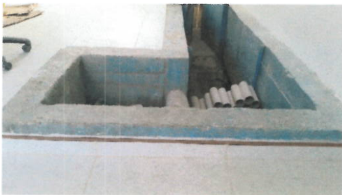
Estado general de la canaleta.
