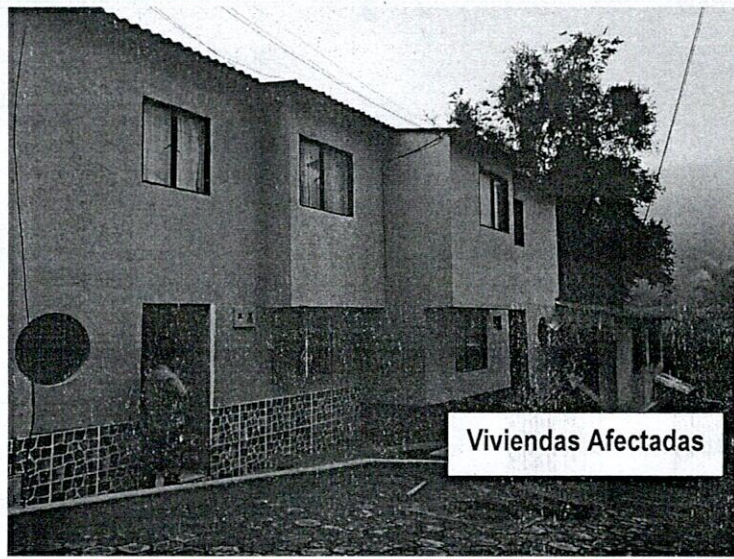
Foto N° 1. Vivienda afectada por inundación y cámara o pozo de inspección
