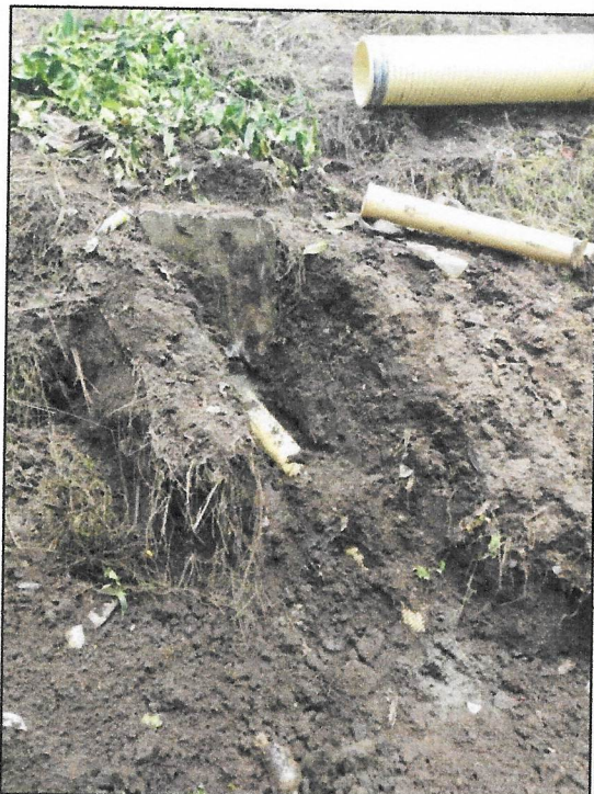
Fotografía 9. Acometida domiciliaria tramo Cámara 10E – 12E.
