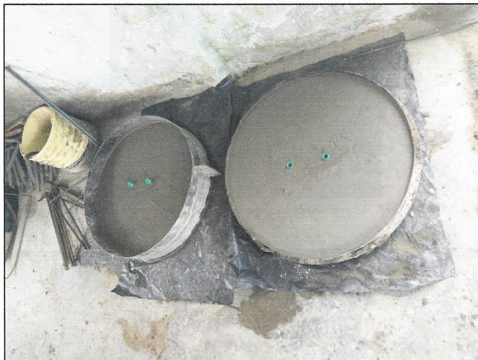
Fotografía 2. Tapas en concreto D=0,7m
