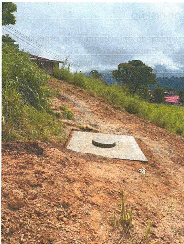
Cámara de 1,2 m de diámetro sobre red de 12" corrugada
