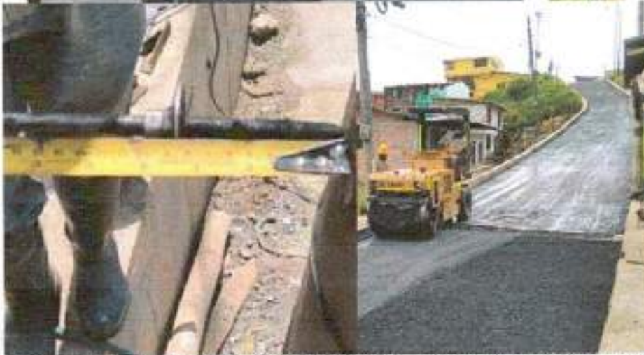
Pavimentación del tramo 3, con mezcla densa en caliente – 19 y espesor de 7 cm de acuerdo con el diseño del pavimento flexible.
