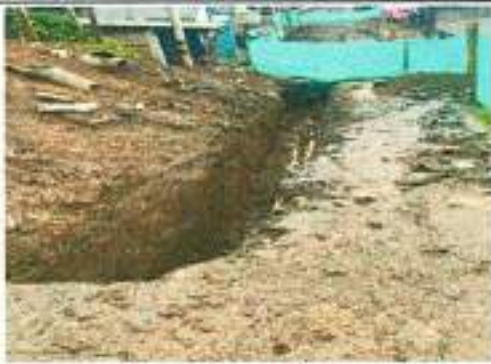
Estado de obra por fuertes lluvias
