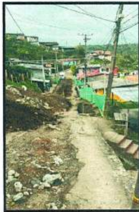
Fotografía Nro. 2 - deterioro del cerramiento
