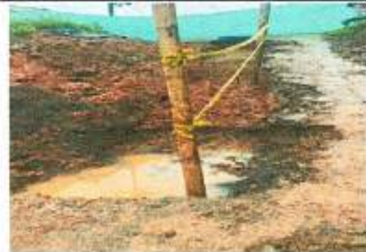
Estado de obra por fuertes lluvias
