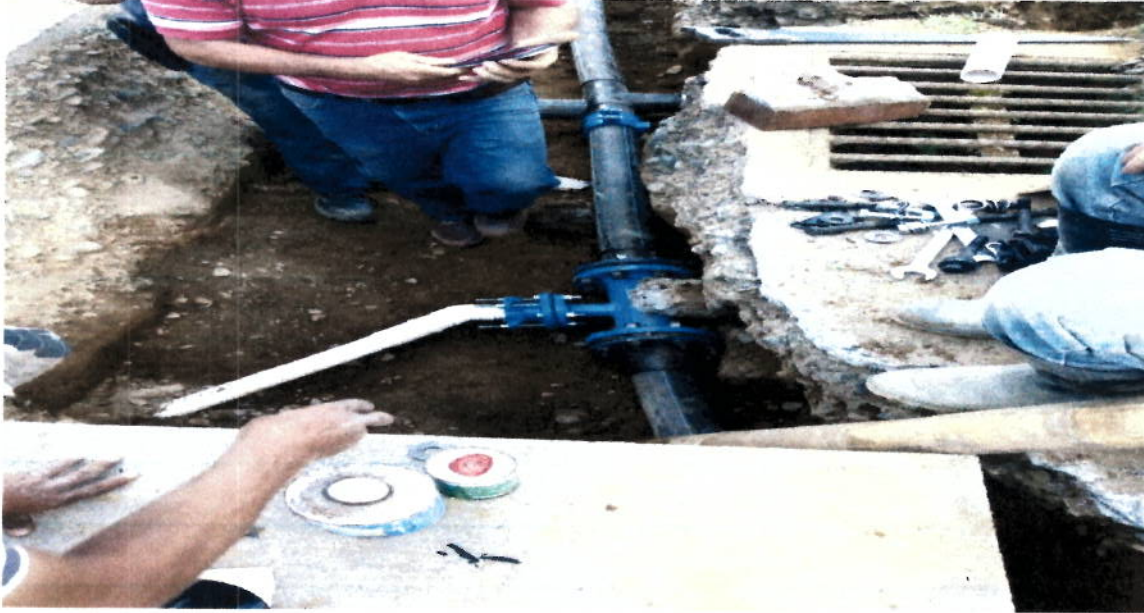
Instalacion de Tee y conexión de 2" para lote frente a EDS Santa Lucia
