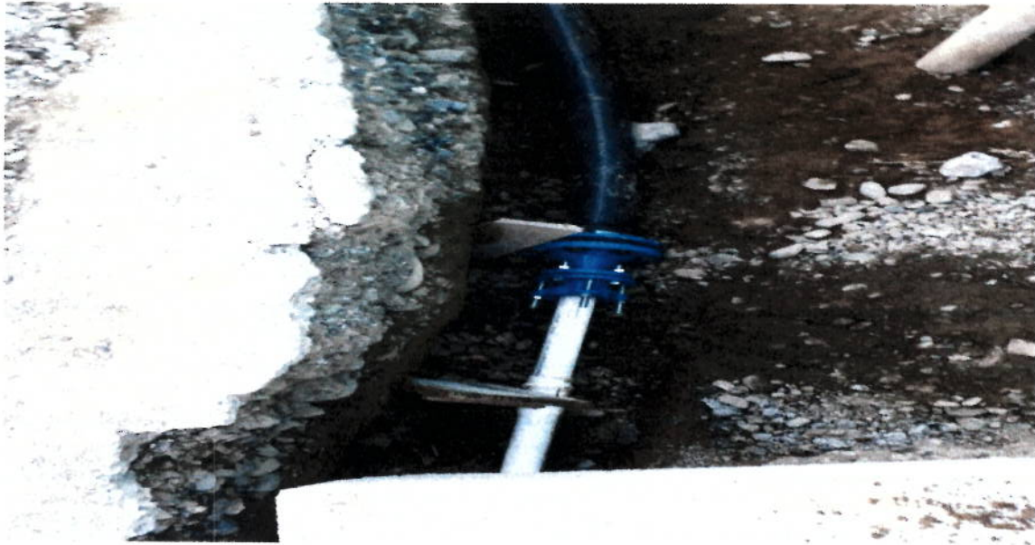
Instalación de reducción y tubería de 2" para empalme final en EDS Santa Lucia
