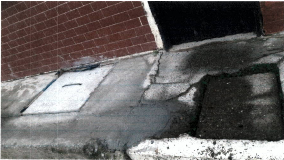
Cajas de Inspección Domiciliarias.
