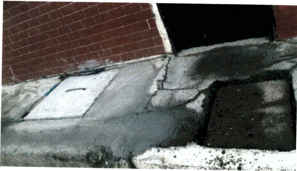
Cajas de Inspección Domiciliarias.
