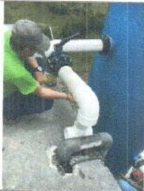
Salida de PTAP a tanque de almacenamiento
