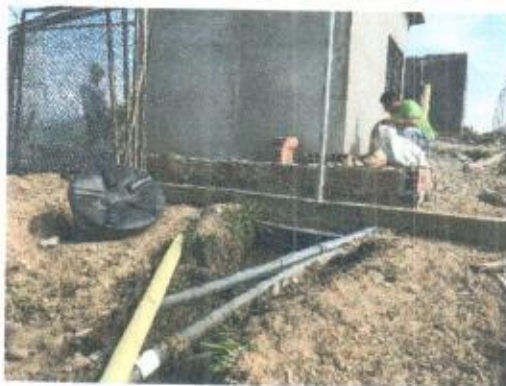
Vista general de tuberías y caseta
