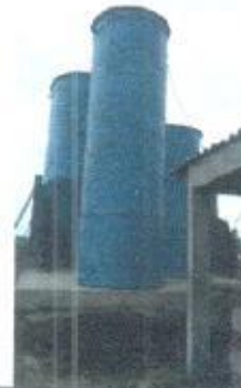
Tanques PTAP en sitio
