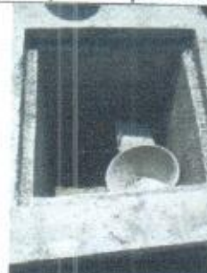
Caja de inspección para lavado de filtro
