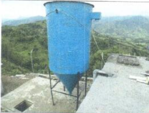
Tanque sedimentador ubicado
