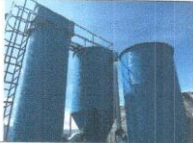
Vista de tanques en funcionamiento con pasarela de inspección
