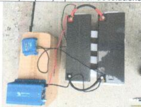
Conexión de sistema fotovoltaico
