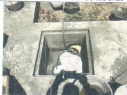
Caja de inspección
