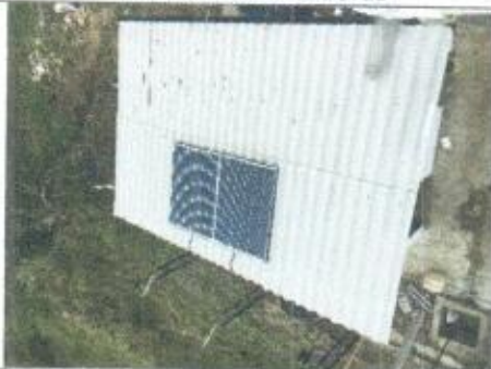
Vista de paneles solares instalados en cubierta
