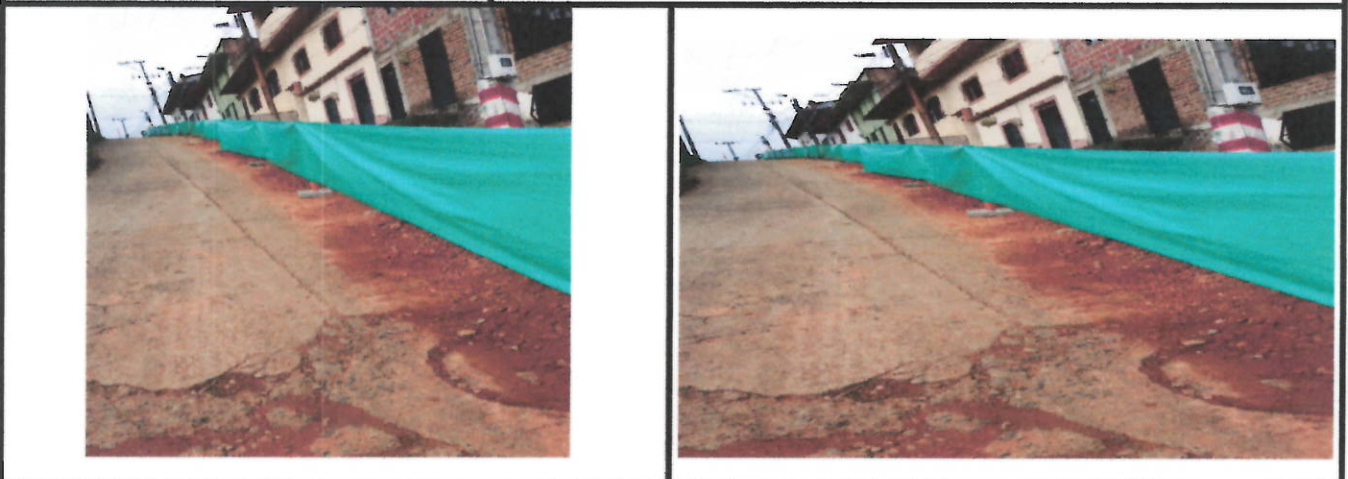
Descripción: Cerramiento con tela verde y soportes de guadua cada 2 metros.
