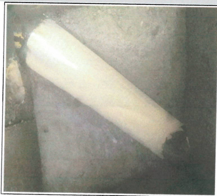
CAJAS DE INSPECCIÓN CRA 7
