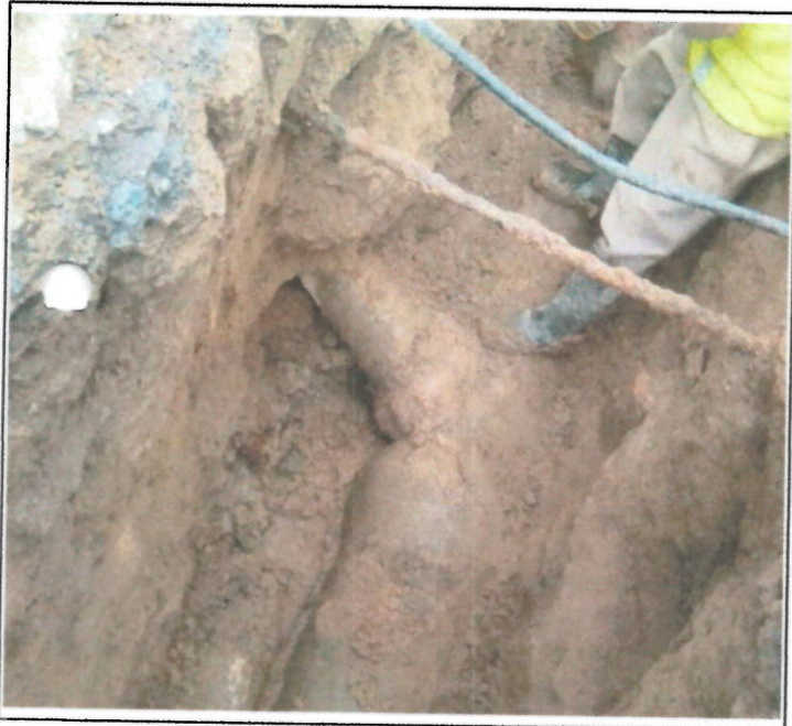
ESTADO DE LAS ACOMETIDAS
