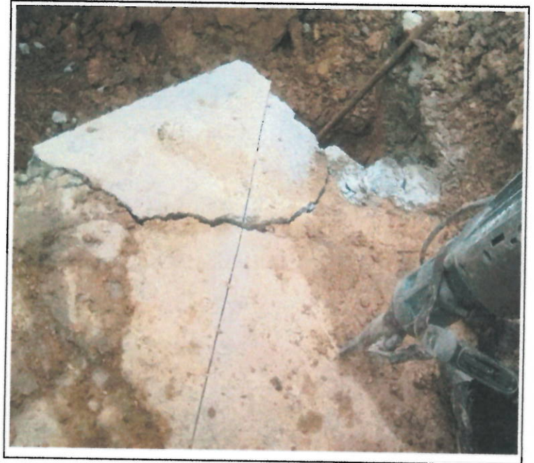
CORTES Y SOBRECORTES DEBIDO AL MAL ESTADO DEL PAVIMENTO
