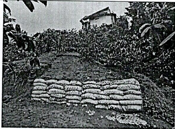
FOTO 5. Se aprecia parte del gavión enterrado y el lleno en el trasdós del muro, perfilado de corona y lleno conformado
