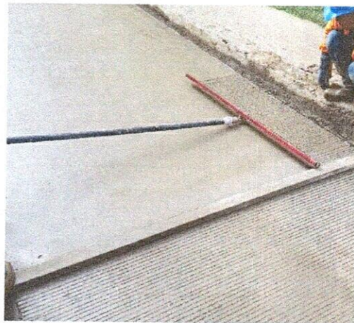
FOTO 16. Rayado del concreto
