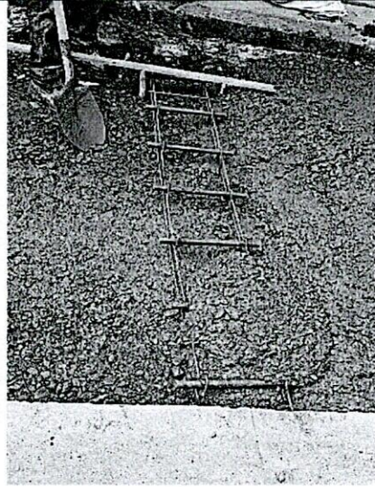
FOTO 6. Detalle uso de dovelas de acero para transición de cargas entre las losas de concreto vaciadas
