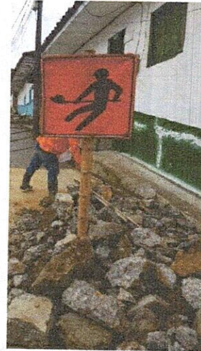
FOTO 2. Señal hombres trabajando
