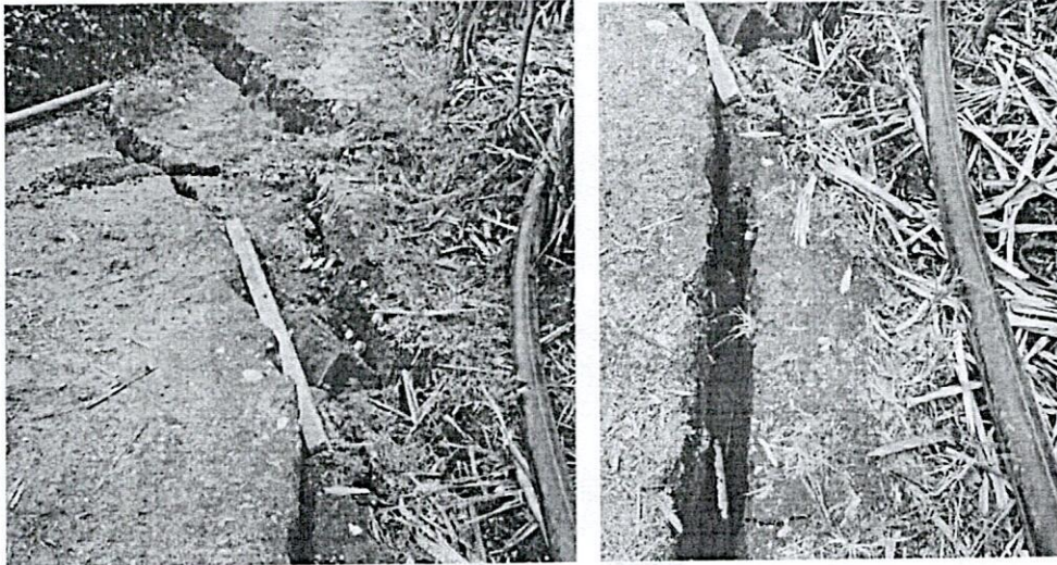
Imagen 5 y 6. Evidencia de la situación de emergencia por exposición de tubería ante los movimientos del terreno; aprestamiento de la tubería para instalación.
