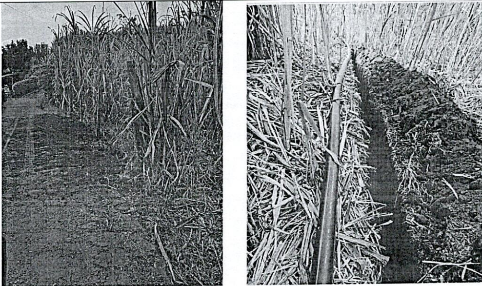
Imagen 7 y 8 Tramo de cañaduzal para intervención con rocería, limpieza, excavación instalación de polietileno, llenos y empalmes de la conducción existente
