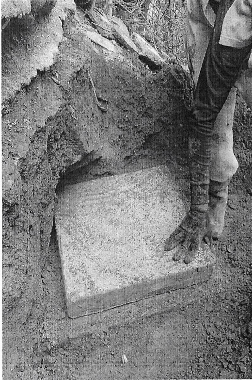
CAJA DE INSPECCIÓN DOMICILIARIA
