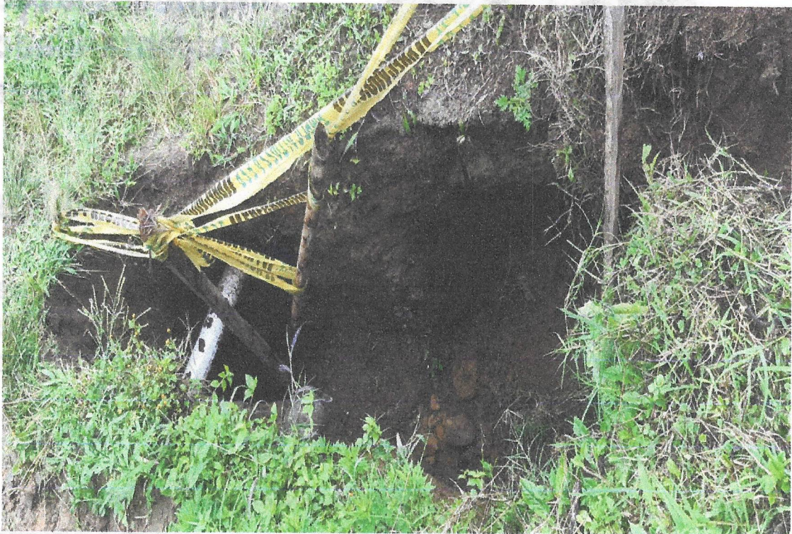
SOCAVACIÓN POR LO CUAL SE PRESENTÓ LA EMERGENCIA
