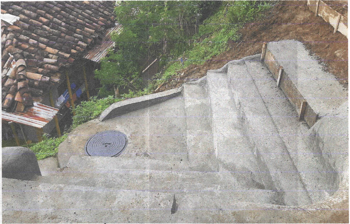
TERMINADO FINAL DE CÁMARA Y GRADAS EN CONCRETO PARA CONFINAMIENTO DEL TERRENO
