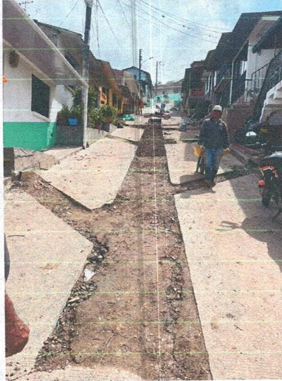
LLENO CON MATERIAL DE OBRA
