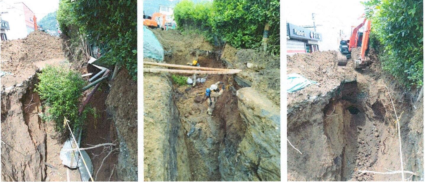
Fotografía No.11,12 y 13// Deslizamientos en brecha y daño de redes de servicios existentes, debido a derrumbamiento de tierra en la brecha por el fuerte invierno.
