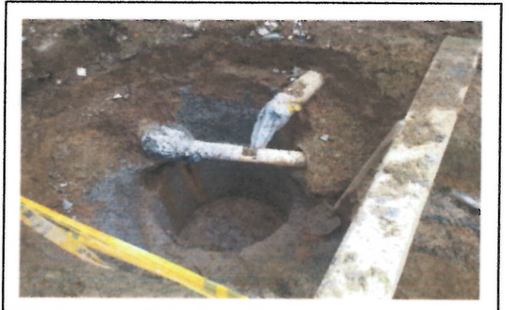
Manejo de aguas Residuales
