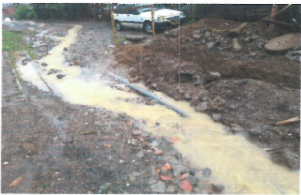
Tuberia de acueducto a nivel de la rasante
