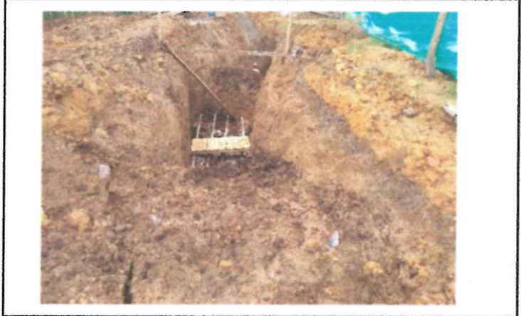
Sobrancho en la excavacion - lleno mal compactado
