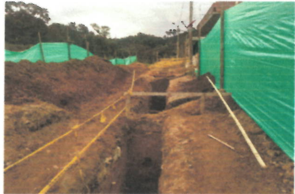
Señalizacion de brechas
