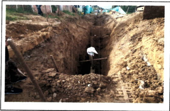
Acometida de alcantarillado perpendicular a la red
