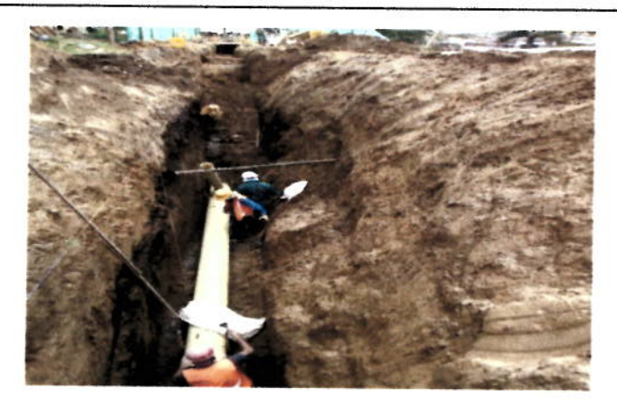
Acometida de alcantarillado perpendicular a la red
