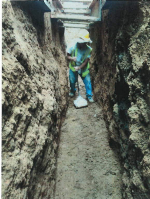
Foto 15. Llenos en brecha de la calle 8 entre carreras 2 y 3.
