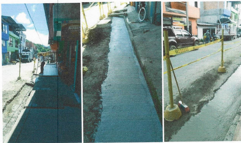
Fotos 12, 13, 14 ,15 y 16. Demolición, excavación en conglomerado, instalación de tubería PVC 3", prueba de presión, instalación de domiciliarias, Llenos, sub base granular compactada, cuneta de concreto acelerado.
