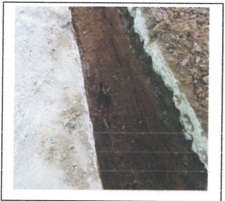
ESTADO COLMATADO DE LA TUBERIA DE CONCRETO EXISTENTE
