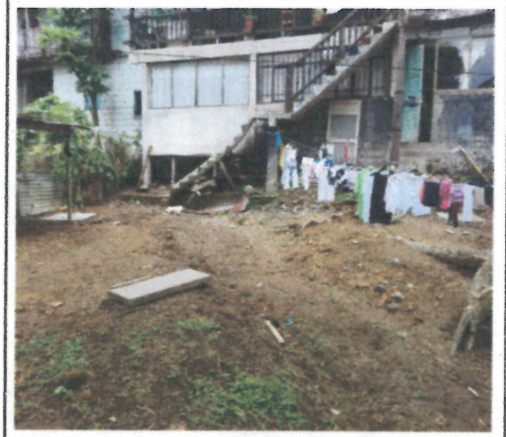
AGUAS ENCAUSADAS POR RED DE ALCANTARILLADO DE 12"
