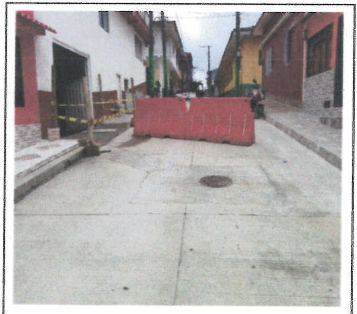
ENTREGA DE LA SERVIDUMBRE A LA RED DE ALCANTARILLADO EN LA CALLE 5
