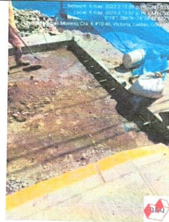
Ilustración 5: Acero de 1" liso, parrilla con acero 3/8" corrugado
