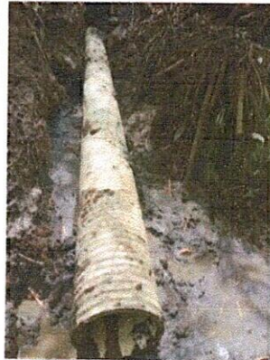
INSTALACION TUBERIA DE 12" PARA LA EVACUACION DE LOS DRENES ENTRE LA CAMARA 17 Y CAMARA 18
