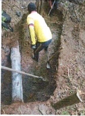
CONSTRUCCION BRECHAS PARA FILTRO CON GEOTEXTIL NT = 1600 Y TUBERIA DREN DE 100ML ENTRE LA CAMARA 17 Y CAMARA 18
