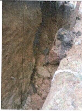
DERRUMBRE EN BRECHA EN EL TRAMO ENTRE CAMARA 16 Y CAMARA 17
