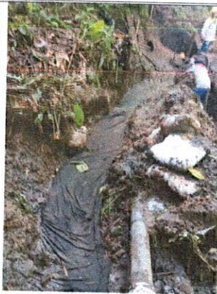
CULMINACION DE FILTRO ENTRE CAMARA 17 Y CAMARA 18
