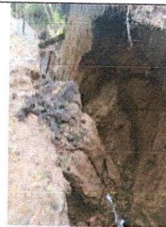
DERRUMBE EN BRECHA DEL TRAMO A CAMARA
