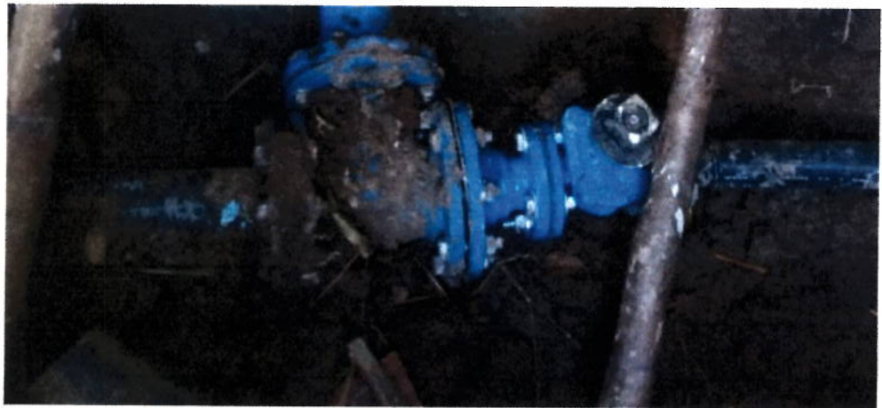
Instalación de reducción de 4" a 2" y válvula de compuerta de 2"
