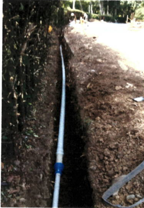
Reducción de tubería de 3" a tubería de 2"
