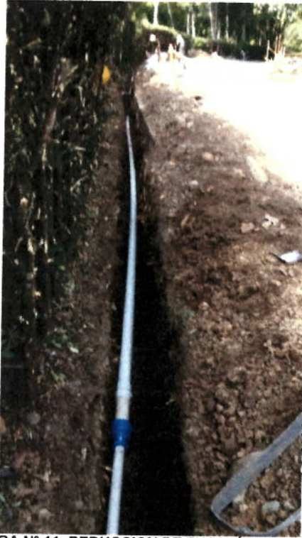
FIGURA N° 11. REDUCCION DE TUBERÍA DE 3" A 2"
