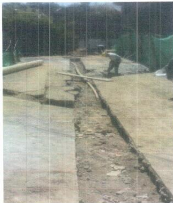
PAVIMENTO EN MAL ESTADO
