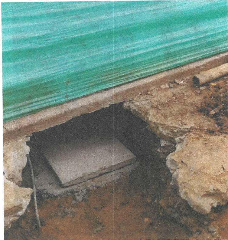
CAJAS DE INSPECCIÓN DOMICILIARIA
