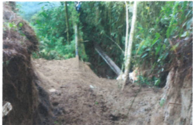
TUBERIA SOBRE EL TERRENO
