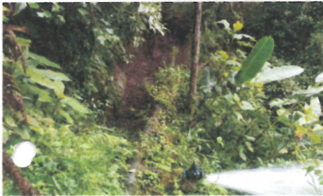
DERRUMBE TUBERIA EN EL AIRE
