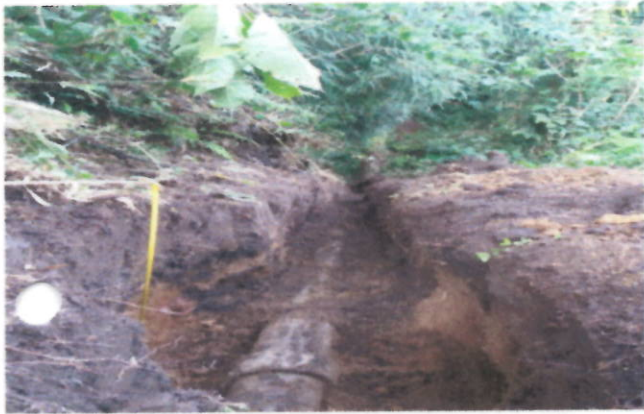
TUBERIA DE ASBESTO CEMENTO DE 6"
