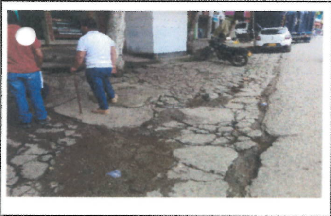
ESTADO DEL PAVIMENTO CAMARA
