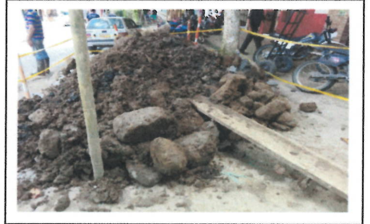
MATERIAL EN MAL ESTADO PRODUCTO EXCAVACION
