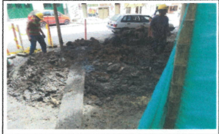
MATERIAL PUTREFACTO DE EXCAVACION
