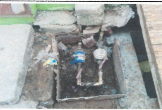
CAJAS PARA MEDIDORES EXISTENTES
