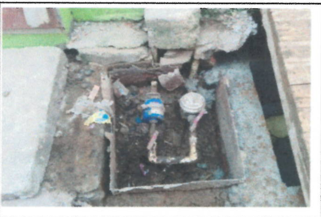
CAJAS PARA MEDIDORES EXISTENTES
