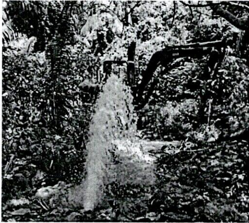
FOTO 1. Sitio del daño de acueducto, correspondiente con la emergencia
