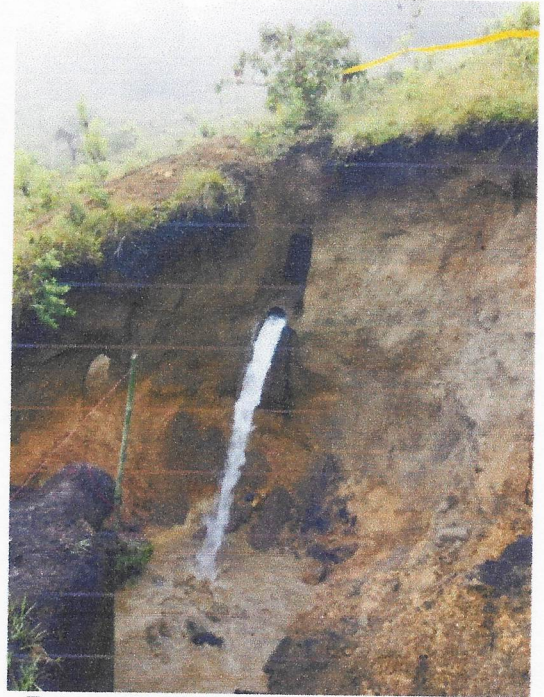
Fotografía No.6. Condiciones iniciales del socavón
