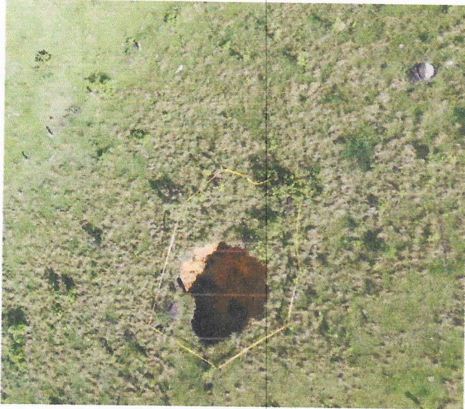
Fotografía No.5. Vista Área de las condiciones iniciales del socavón.
