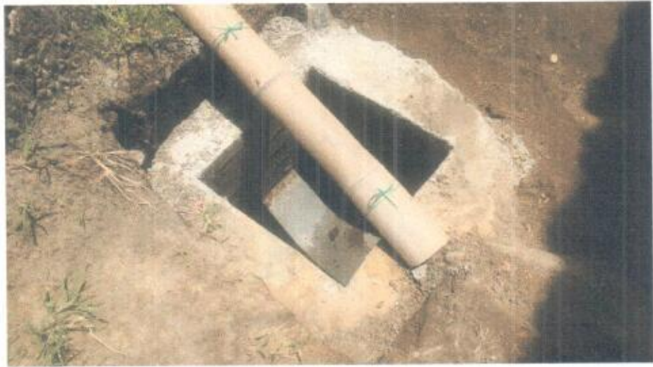
CAJAS DE INSPECCION
