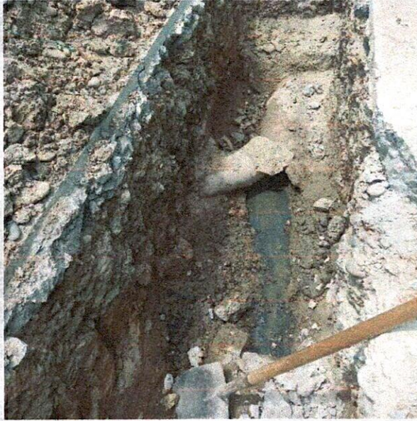
Ilustración 15: tubería de 12" en asbesto cemento totalmente colapsada
