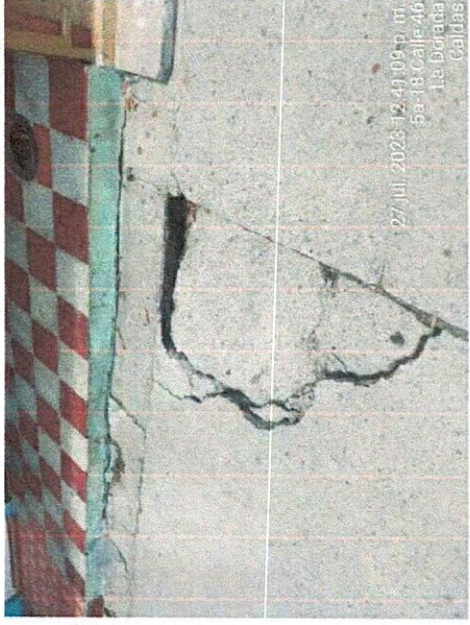
Ilustración 22: hundimiento de placa
