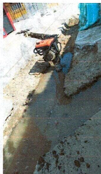
Ilustración 36: inundación de brecha por daños en la red de acueducto
