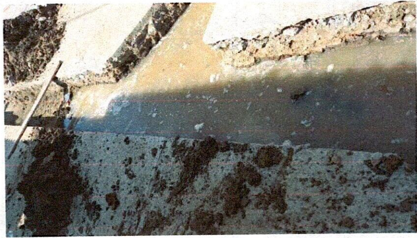
Ilustración 36: inundación de brecha por daños en la red de acueducto
