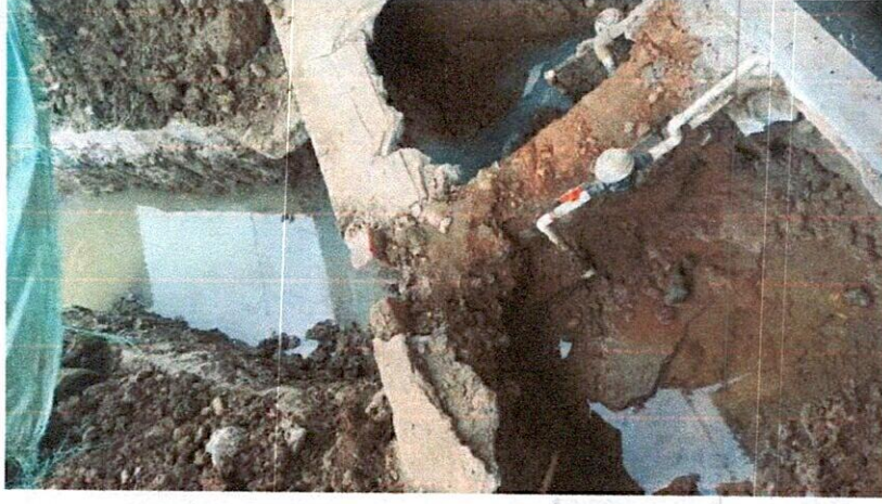
Ilustración 34: inundación de brecha con aguas negras
