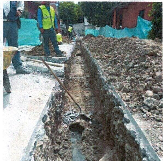
Ilustración 14: Línea principal de tubería de 12"
